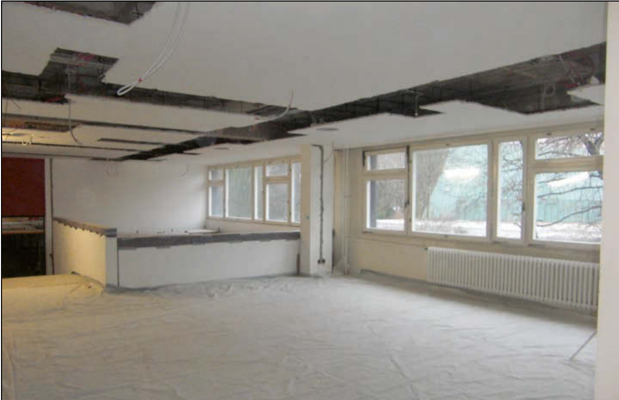
Abb. 10: Akademie der Künste, Verwaltungsgebäude, 1. Obergeschoss, geöffnete Rabitzdecke
